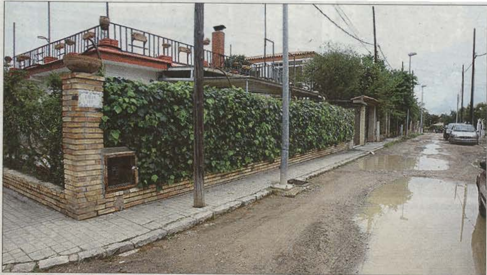
Una de las calles del barrio de Masías que se encuentra sin asfalto. A. COMES
