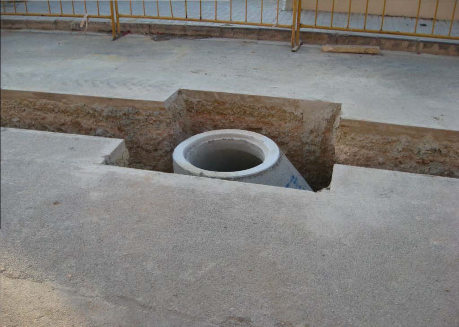
Pozo de registro sin acometidas en la calle 145.
